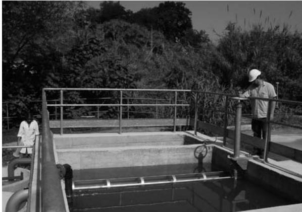
Depuratore d'acqua di impianto
