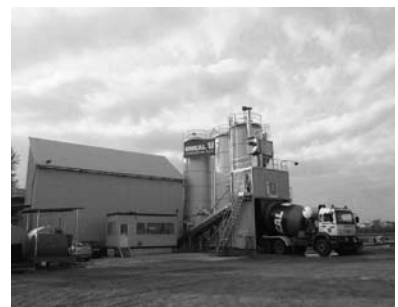
Un impianto per la produzione di calcestruzzo preconfezionato.
