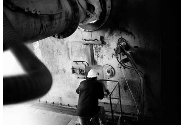
Verifica della corretta combustione in un forno
